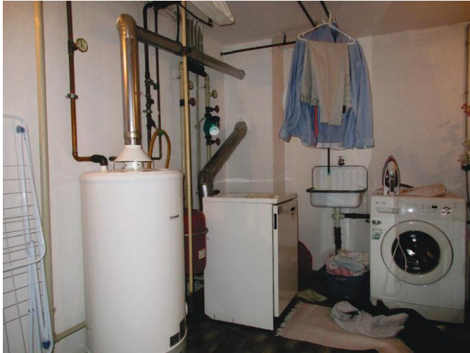
Hauswirtschaftsraum mit Heizung
